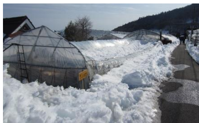
大雪で倒壊した山梨県内の農業用ハウス
