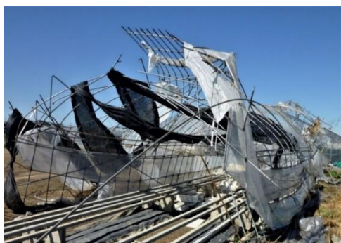
台風被害の様子
